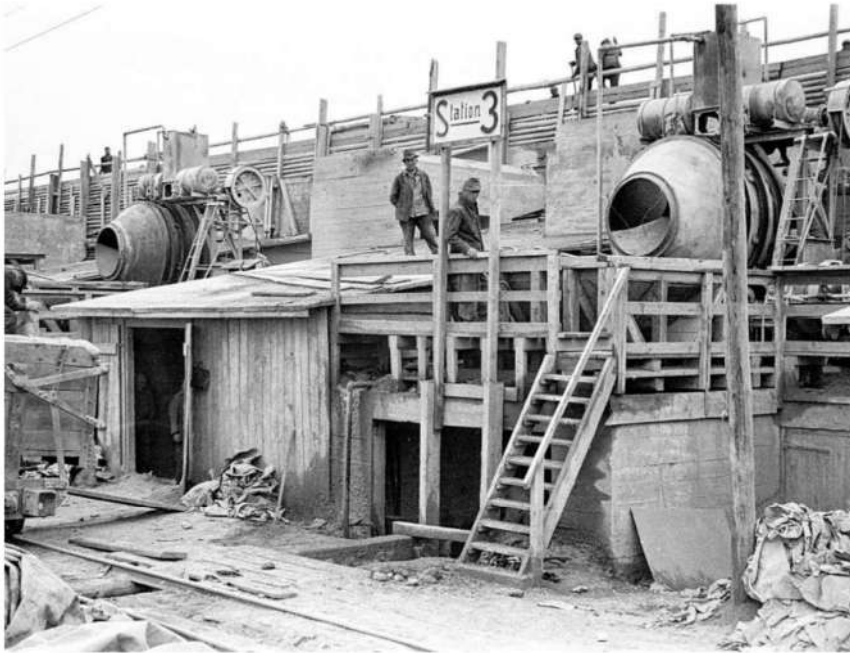
Tausende Zwangsarbeiter errichteten von 1943 bis 1945 den U-Boot-Bunker Valentin. Das Foto zeigt die Betonmischer. FOTO: DENKORT BUNKER VALENTIN
