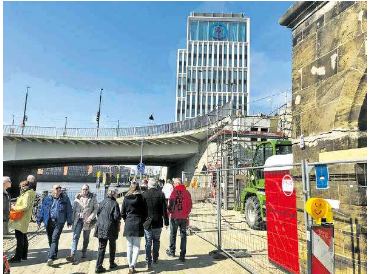
Baustelle des Mahnmals im April. in unmittelbarer Nähe zum Logistikkonzern Kühne+Nagel Foto: Jean-Philipp Baeck
