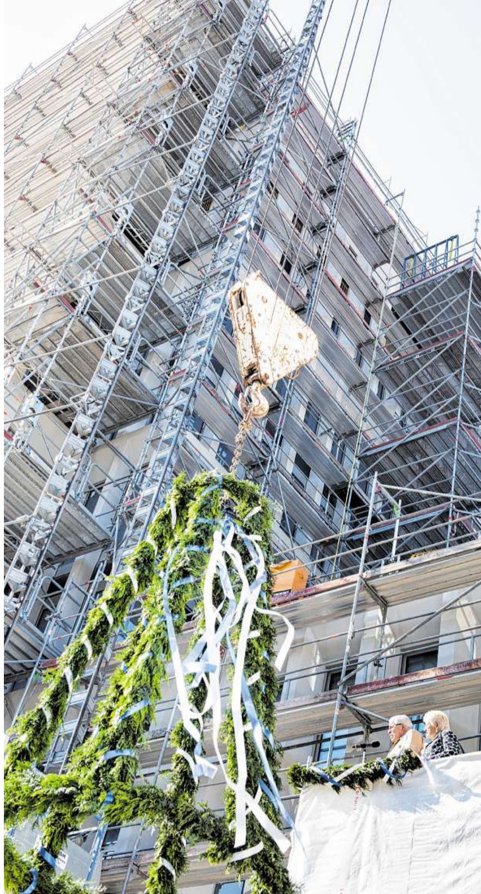
In gut zehn Metern Höhe hängt der Richtkranz für das neue Gebäude von Kühne + Nagel bereit. Daneben stehen Klaus-Michael Kühne und seine Ehefrau Christine. FOTO: CHRISTINA KUHAUPT
