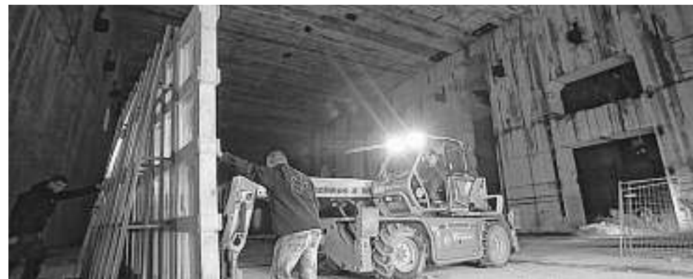
Ein Baufahrzeug, halb Kran, halb Bagger, bringt eines der Fenster in Position. Besucher können durch dicke Scheiben ins Innere des Bunkers blicken. FOTOS: CHRISTIAN KOSAK
